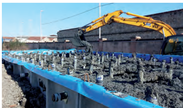
Figura 3 – Vasca di trattamento durante il riempimento e in esercizio
