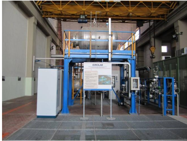
Figura 7: L'impianto pilota IdroLab
