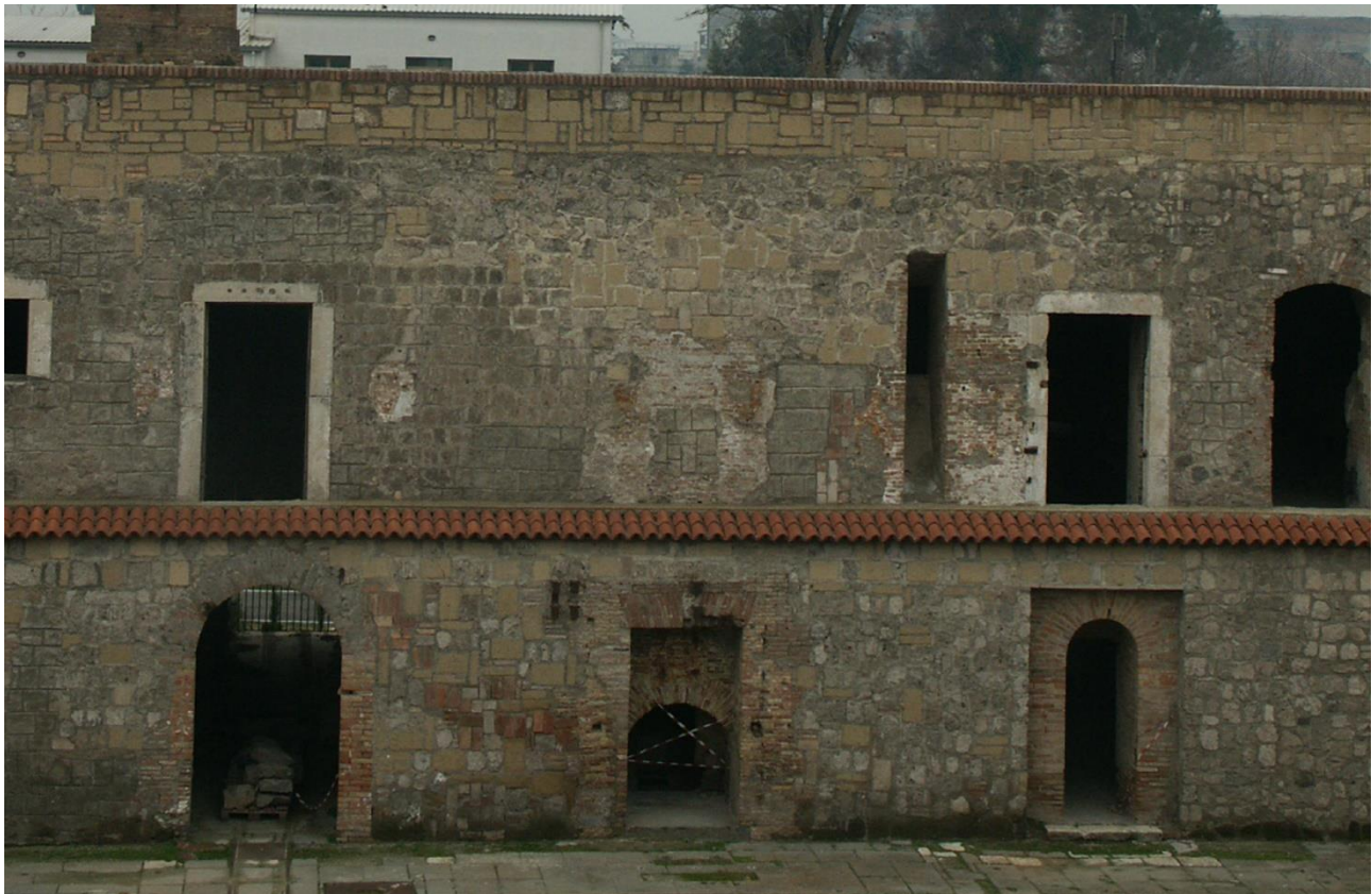
Fig. 7 - Particolare della parete verso sud-ovest del cortile interno, 2004. Sono visibili gli interventi di integrazione muraria eseguiti negli ultimi decenni. Purtroppo, in questi anni le condizioni generali di manutenzione del Castello, anche a causa del suo parziale utilizzo, sono peggiorate rispetto a quanto emerge dalla documentazione fotografica del 2004. Né in questi mesi è stato possibile accedervi, nonostante le richieste avanzate
